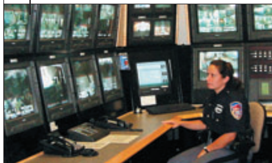
Sicherheitsleitstand Central control room
